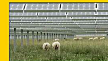
农场牧场太阳能发电系统/ Farm solar generation system
